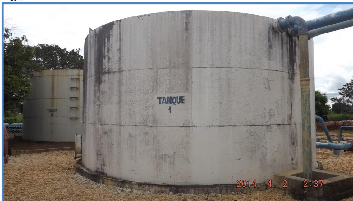
Figura 13 - Reservatório Apoiado (Tanque 01), localizado na ETA.
