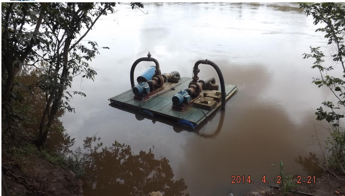
Figura 06 - Conjunto Moto-bomba (Ponto de captação de água).
